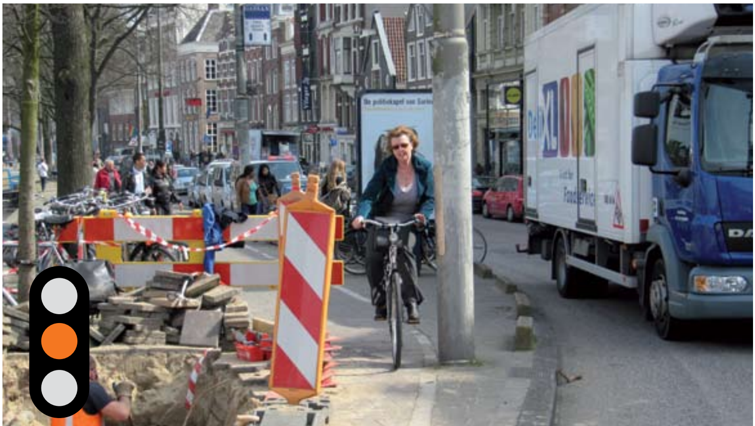
Te krappe doorgang. Behoud goede doorgang voor fietsers en plaats afzettingen voor scheiding met overig verkeer. De lantaarnpaal waar de fietsers zich hier langs wringen, had in dit geval ook met rood-witte banden gemarkeerd kunnen worden. Vooral in de avonden is er reële kans op aanrijdingen.
